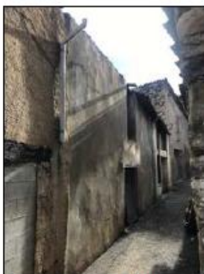
Remise en mauvais état
