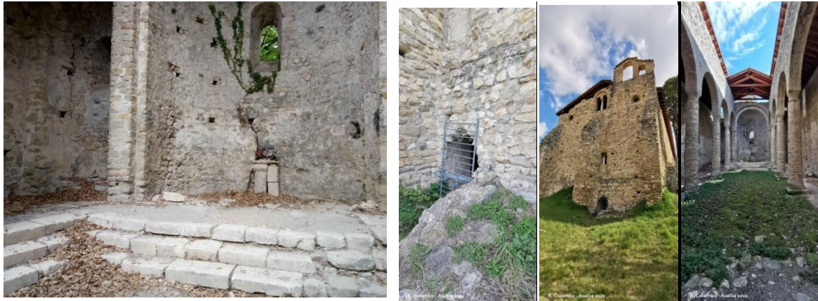
Eglise St-Martin, gîte potentiel fort pour les chiroptères avec de nombreuses fissures dans les murs
